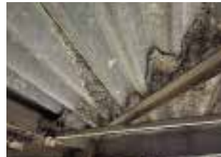
岩綿などの剥がれ
